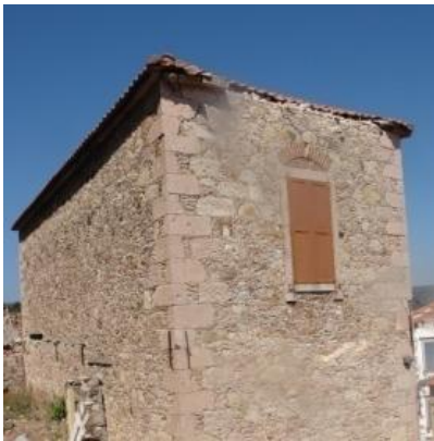
Όπου υπήρχε σύνδεση η δέσιμο με μεταλλικούς ελκυστήρες δεν παρατηρήθηκαν βλάβες.
