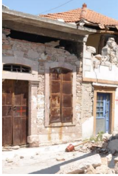
Βλάβη από προσθήκη ασύνδετης πλάκας οπλισμένου σκυροδέματος
