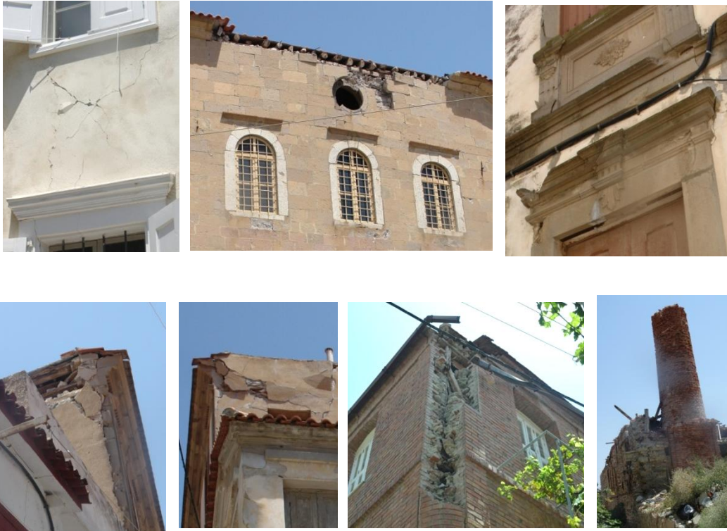
Χαρακτηριστικές βλάβες από τον σεισμό στην περιοχή Ποταμού και Αγ.Νικολάου
